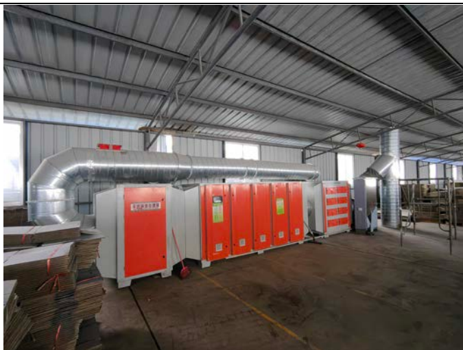
喷漆废气处理装置
